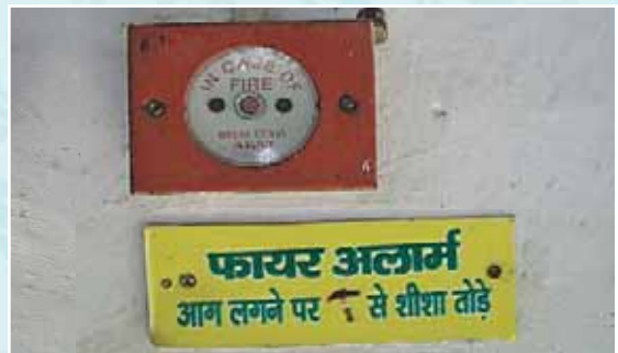
Emergency Fire Alarm Point सूचना तक्रार पेटी
